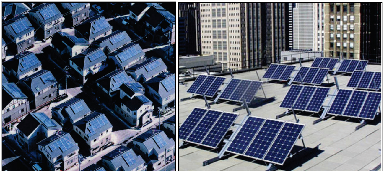
Սկար 3. Շենքերի վրա տեղադրված ՖՎ պանելներ, որոնք մոնտաժված են շենքի մյուս տարրերից առանձնացված
